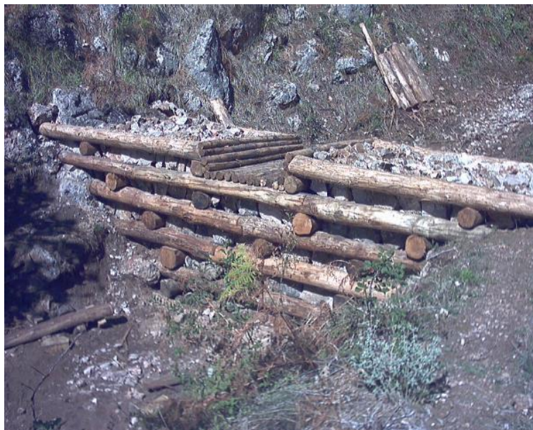
Figura 45: Esempio di briglia in legname e pietrame realizzata dal Consorzio di Bonifica Montana del Gargano
