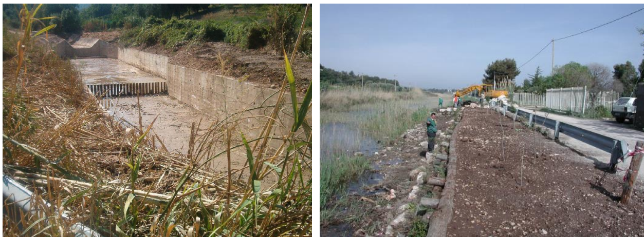
Figura 47: Briglia a pettine (a sinistra) e palificata a doppia parete (a destra) realizzati dal Consorzio
